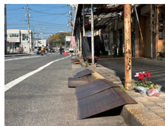
道路と歩道の段差 (2025 年 11 月 30 日)
